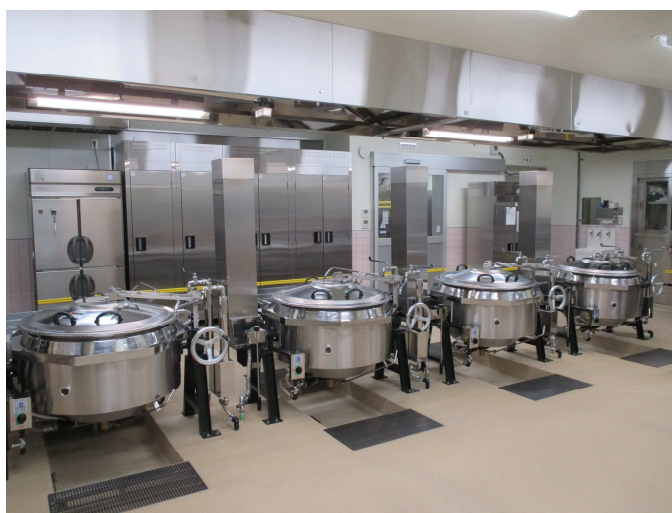
大塔中辺路給食センター調理場内
