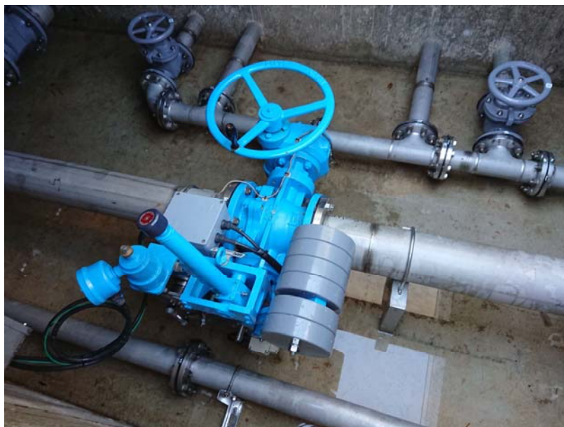
【福定配水池緊急遮断弁設置状況】
