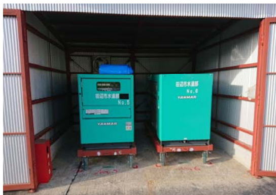
【栗栖川浄水場可搬式自家発電機】
