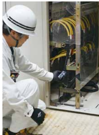
受電盤の電流に異常がないかをチェックしています
