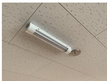
室内照明（蓄電式）
