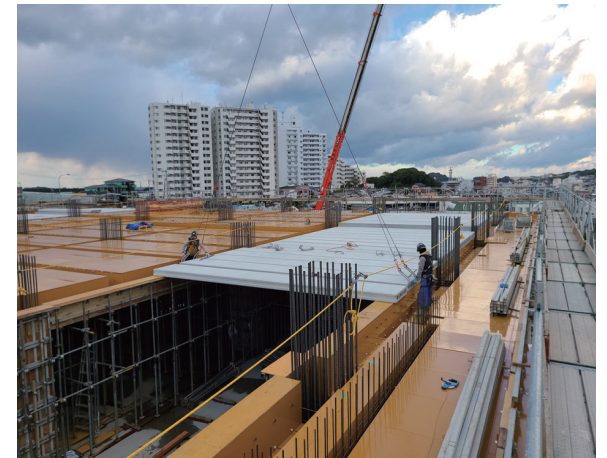
設置の状況です。
