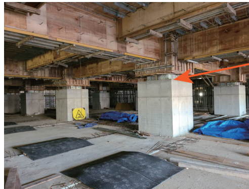
1Fのこの部分が、免震装置です。 支える柱の大きさは、1.75m×1.75mあります
