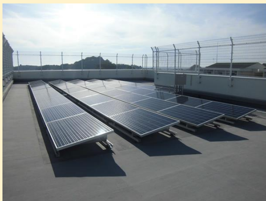
田辺第三小学校(太陽光発電設備)
