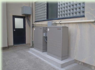
ひがしコミュニティセンター(蓄電池設備)
