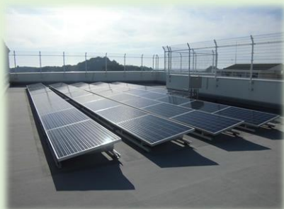
田辺第三小学校(太陽光発電設備)
