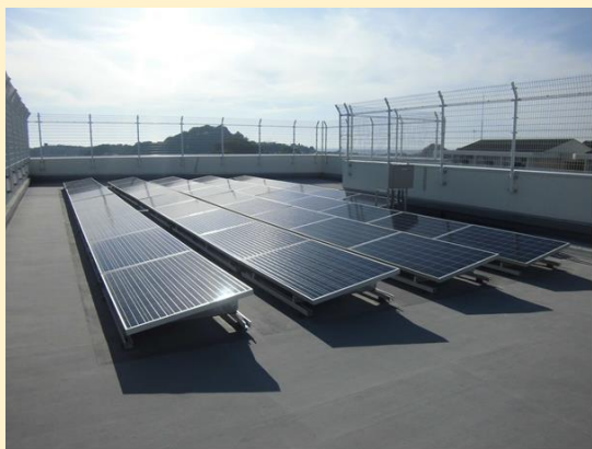
田辺第三小学校(太陽光発電設備)
