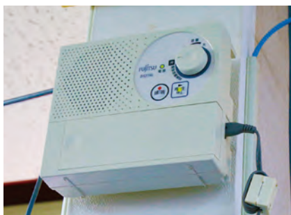
防災行政無線戸別受信機の設置
