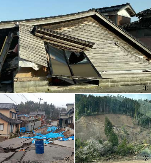
▲①住宅が大きく倒壊②地面の隆起による地割れした道路③山腹から崩壊した斜面
