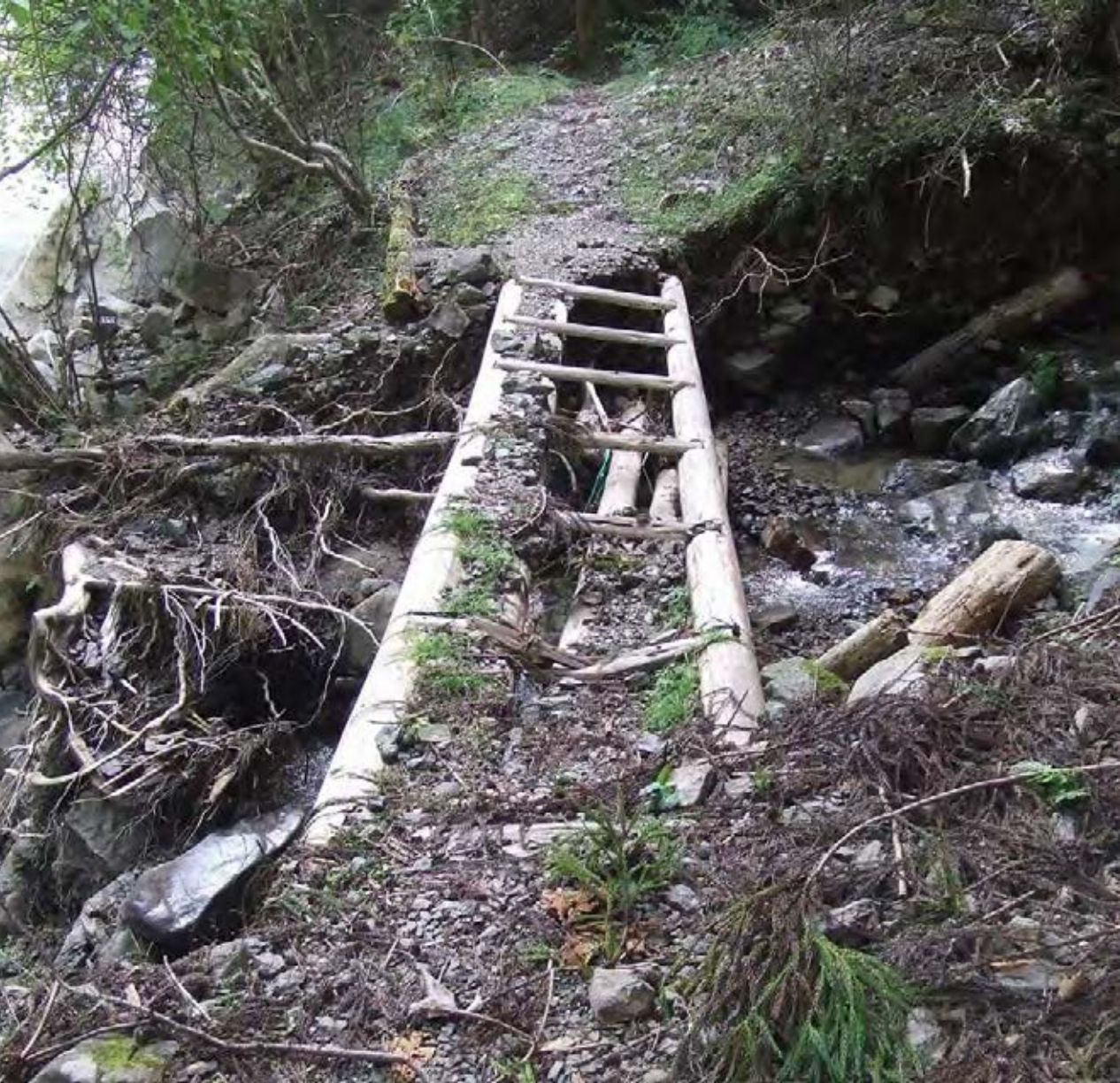
▼損壊した木橋（中辺路町道湯川 どうゆかわ ）
