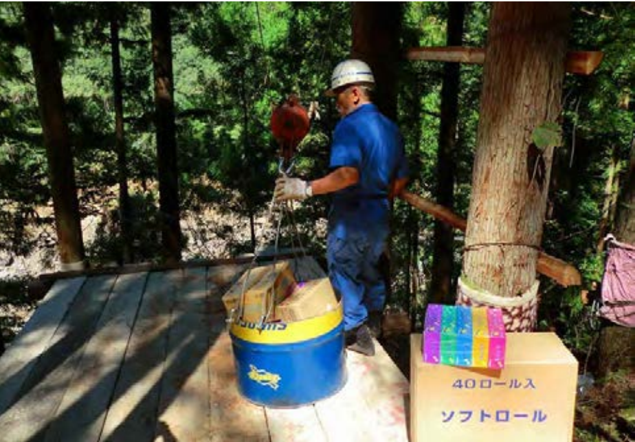
▼道路の崩壊により架線を使って物資のやり取りが行われた（本宮町曲川）
