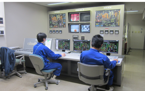
▲焼却施設全体を管理する中央監視室の様子
