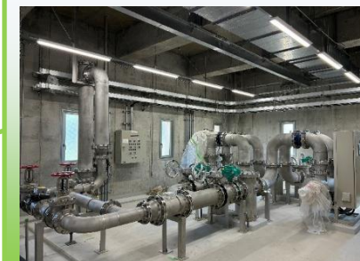
紫外線処理設備
