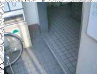
↑ 便所入口の段差 駅構外便所
