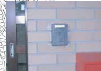
↑1階入り口に設けられたエレベーター呼び出しボタン 案内表示なし(調査後案内表示が設置された)
