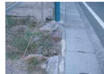
↑湊本通りの路側帯の破損箇所
