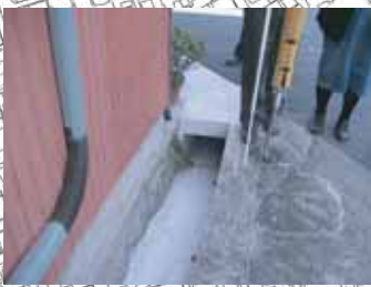
↑中屋敷町の歩道のない通り 溝蓋がない
