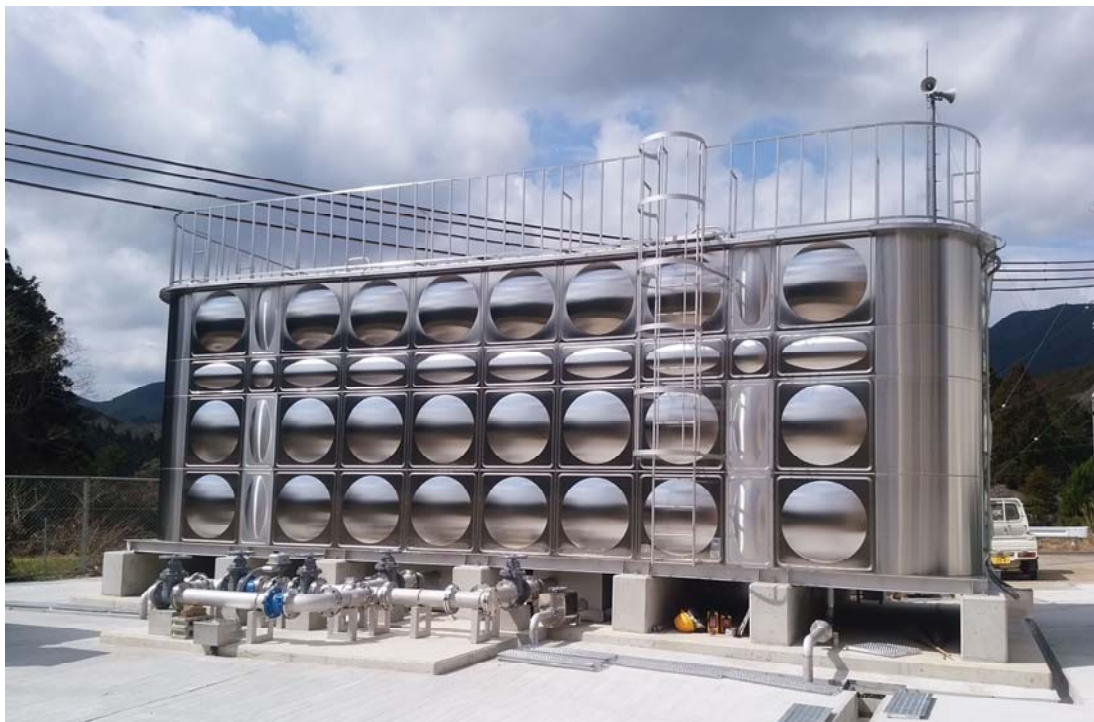
【ステンレス製配水池(栗栖川第1配水池)】
