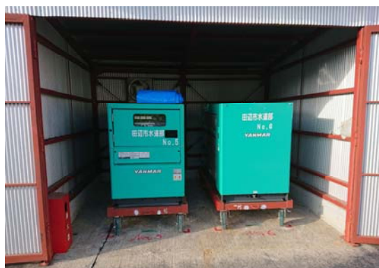
【栗栖川浄水場可搬式自家発電機】
